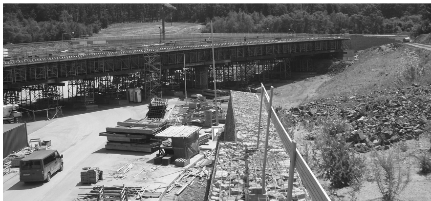
Cestou k připojení na Pražský okruh nemohou být nelegální stavby jako je most odnikud nikam v Komořanech, který stál sto milionů.
